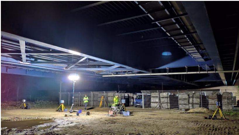
Abbildung 5: Position der vier Profils Scanner unterhalb des Brückenfeldes 1
